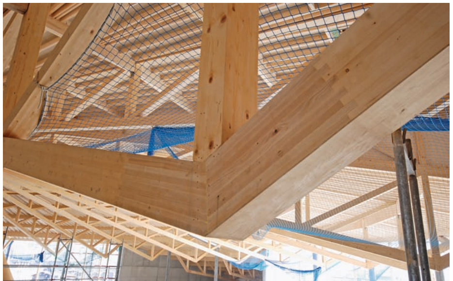
Abbildung 3 : Lokal (an den hoch beanspruchten Partien) mit Eschenholz verstärkter Brett-schicht-träger aus Fichte. Mit solchen Systemen lassen sich die Querschnitte um 30% reduzieren, bei gleichen Leistungen; Hersteller: Firma Neue Holzbau AG, Lungern.
