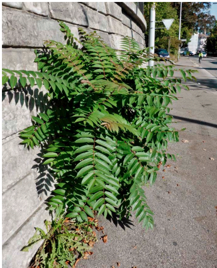
Erhöhte Unterhaltskosten und Schäden an Bauten: Zürich, Merkurstrasse
