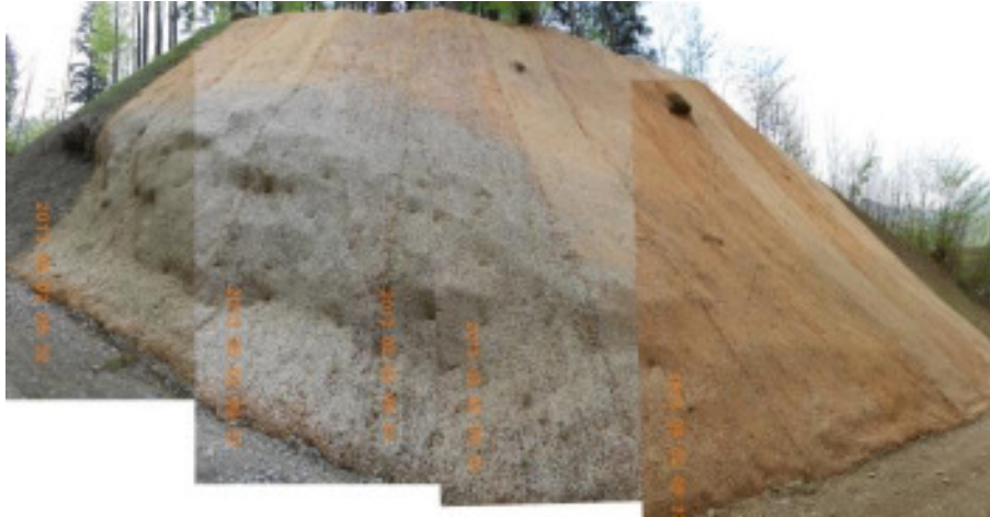
Abbildung 11: Zustand der Versuchsfläche ein Monat nach dem Einbau.
