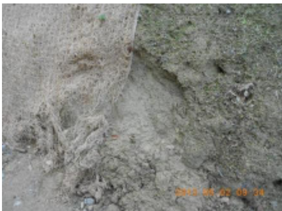
Abbildung 13: Erosionsstellen am Übergang zwischen Holzwollevlies und Kontrollfläche.
