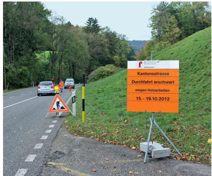
Hier sind die Strassenbenützer sogar schon im Vorhinein informiert worden. Achtung: Signale nicht in die Fahrbahn stellen, sondern an den Strassenrand!
