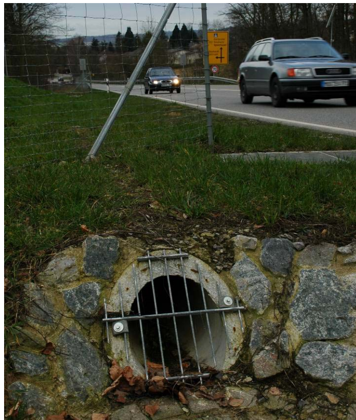
Abb. 4-2: Alle Röhrendurchlässe sind mit zugeschnittenen Doppelstabmatten gegen das Eindringen mittelgroßer Tiere wie Dachs oder Fuchs gesichert worden. Eine einfache, effiziente und kostengünstige Maßnahme. Die Gitter werden nur auf der höher liegenden Seite angebracht, so dass Schwemmgut nicht das Innere der Röhren verstopfen kann, sondern davor hängen bleibt und leicht entfernt werden kann. Der Röhreninnenraum wird durch fließendes Wasser ausgewaschen.
