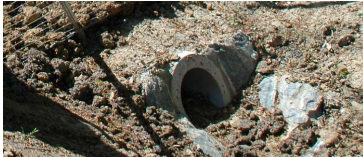
Abb. 4-1: Dachse nutzten kurz nach der Fertigstellung des Leitzauns im April 2006 die Röhren für den Wasserabfluss zum Eindringen in den gezäunten Bereich. An einer Stelle, an der der Leitzaun nicht dachssicher eingegraben und nur lockere Erde angehäuft war, konnte sogar eine Untergrabung festgestellt werden. In dieser Anfangsphase wurde ein überfahrener Dachs noch vor dem Beginn des Monitoring am 01.07.2006 registriert.
