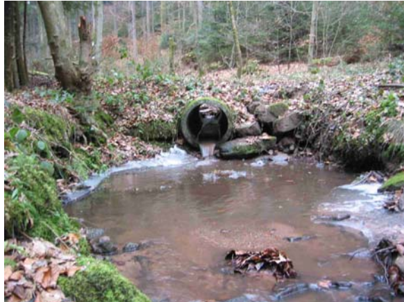
schwer passierbare verdolte Gewässerquerung Länge: 6 m Durchmesser: 600 mm
