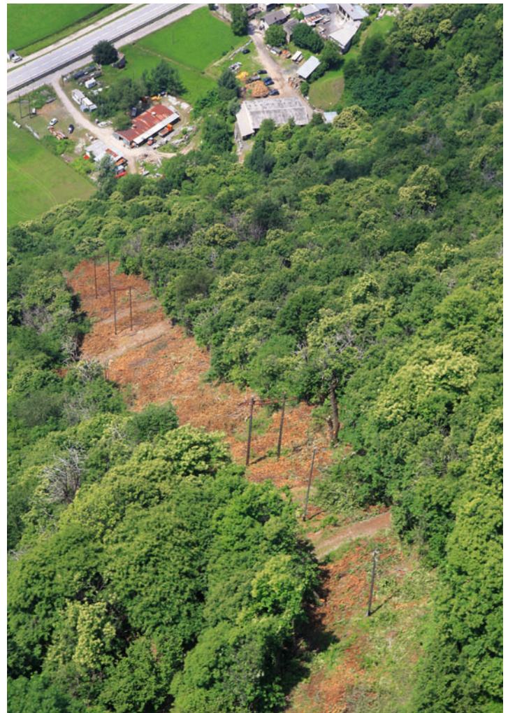
Das Freileitungs-Trasse der Società Elettrica Sopracenerina SES in der Nähe von Biasca nach erfolgter Freischneidung der Stromleitungen. Das Trasse wurde zuvor konventionell ausgelichtet.
